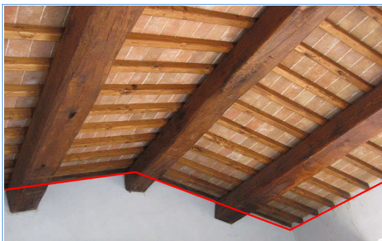
Illustrazione 6: intradosso di strutture composte con interasse dell'orditura secondaria non superiore a 80cm
